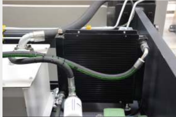
Hidrolik Yağ Soğutucu Sistemi
